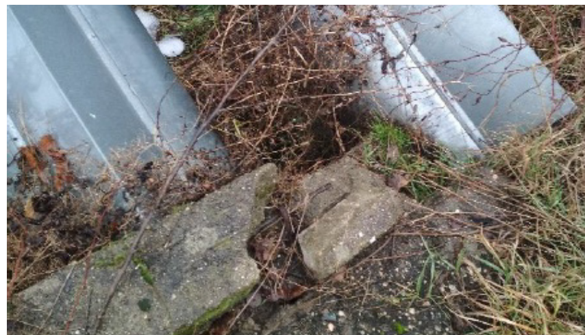
Obrázek 55: Poškození betonové konstrukce krytí horkovodu mezi kompenzátory 25 a 26 (pod můstkem)
