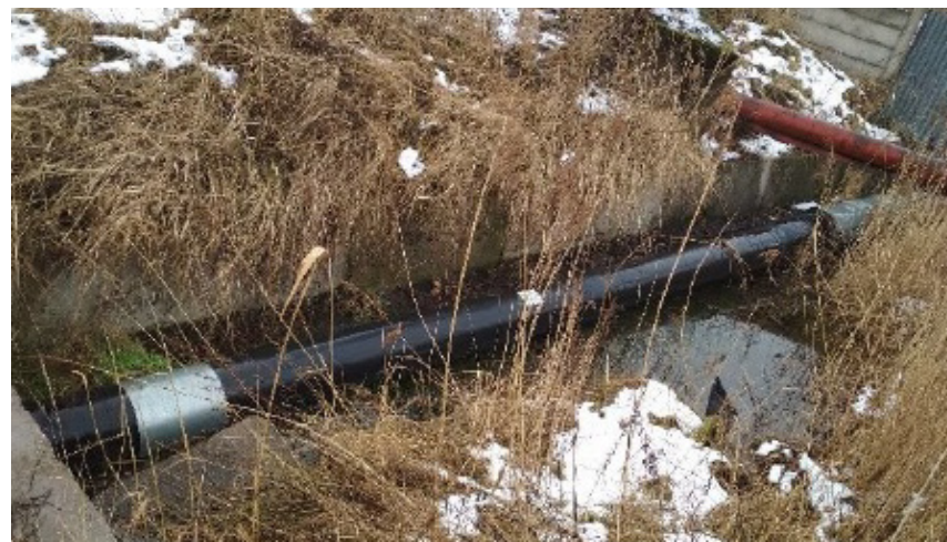
Obrázek 39: Poškozené tepelné izolace horkovodu
