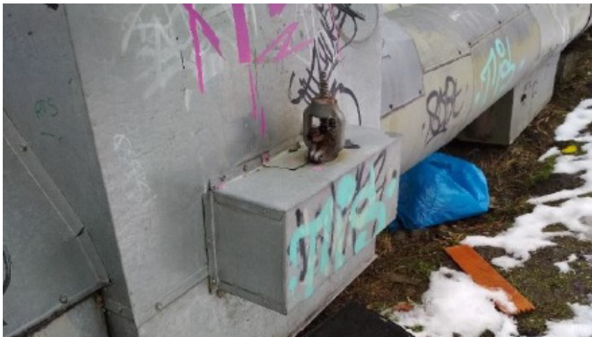
Obrázek 50: Bypass armatury horkovodu nechráněný proti nedovolené manipulaci
