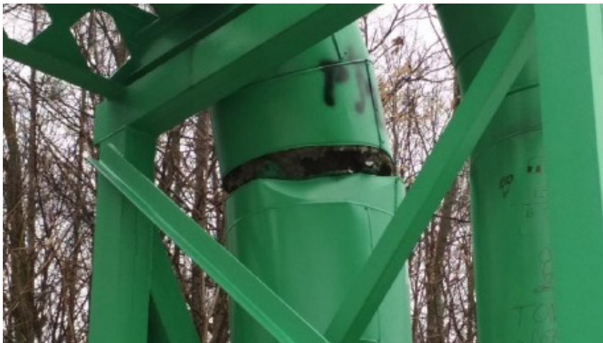
Obrázek 38: Poškozené tepelné izolace horkovodu
