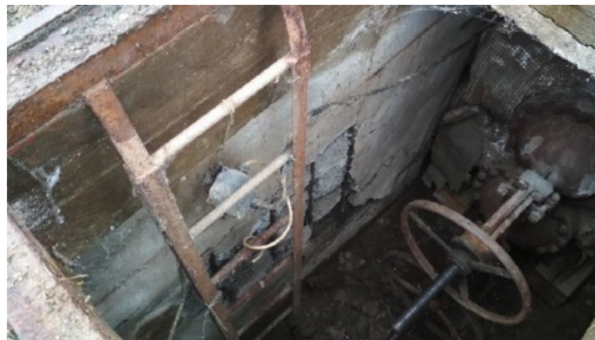
Obrázek 51: Neupevněná elektroinstalace v kolektoru
