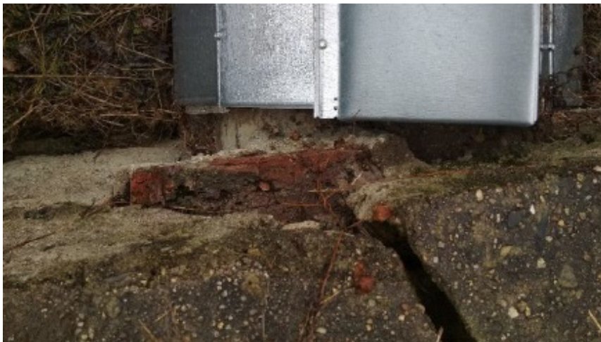
Obrázek 54: Poškození betonové konstrukce krytí horkovodu mezi kompenzátory 25 a 26 (pod můstkem)
