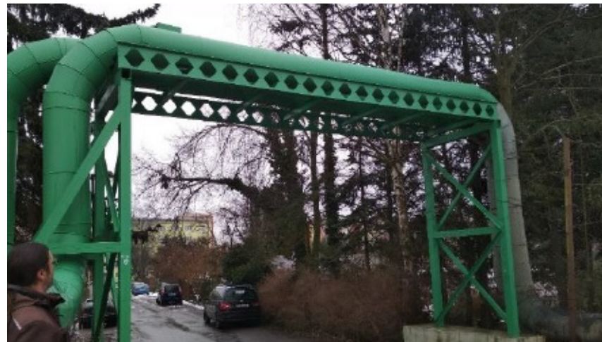
Obrázek 56: Neoznačení podjezdové výšky nad komunikací
