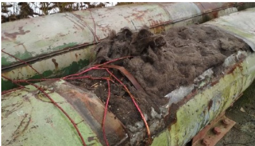
Obrázek 37: Poškozené tepelné izolace horkovodu
