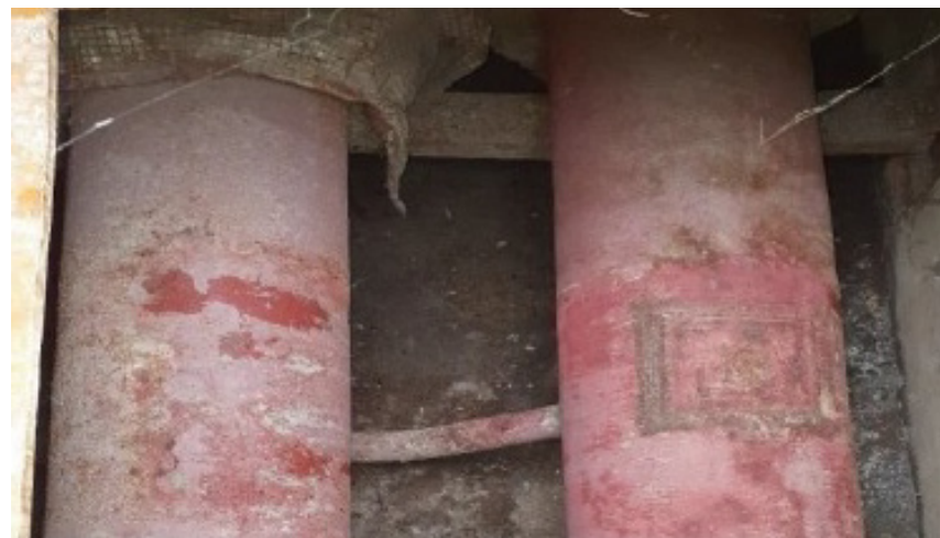
Obrázek 47: Nesprávně provedená a nezdokumentovaná oprava potrubí
