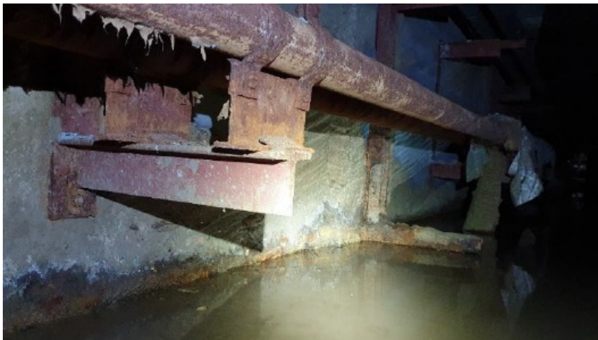
Obrázek 42: Povrchové koroze neizolované části horkovodního potrubí a koroze nosných třmenů potrubí v potrubním kolektoru
