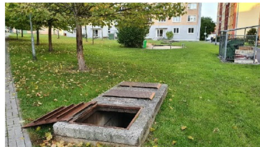
Obrázek 60: Nezajištěné vstupy do potrubního kolektoru proti přístupu nepovolaných osob
