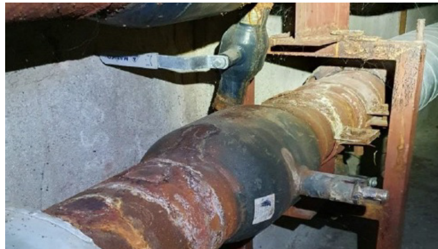
Obrázek 40: Povrchové koroze části neizolované části horkovodního potrubí v potrubním kolektoru
