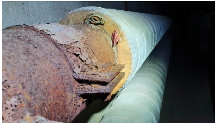
Obrázek 44: Povrchové koroze neizolované části horkovodního potrubí a koroze nosných třmenů potrubí v potrubním kolektoru
