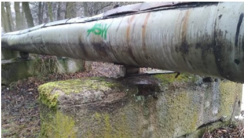
Obrázek 53: Poškození betonového bloku nosné konstrukce horkovodního potrubí
