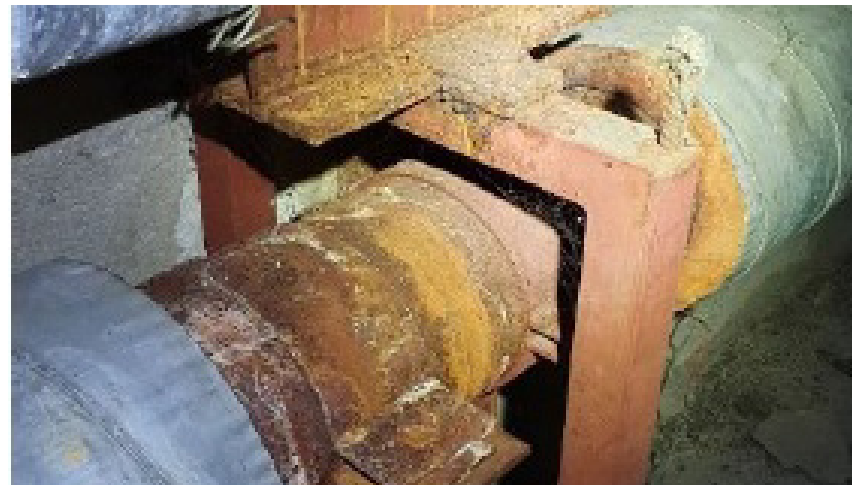
Obrázek 43: Povrchové koroze neizolované části horkovodního potrubí a koroze nosných třmenů potrubí v potrubním kolektoru
