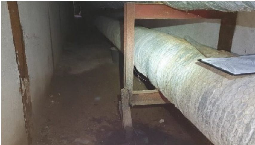
Obrázek 46: Poškození opěrné konstrukce horkovodního potrubí v potrubním kolektoru
