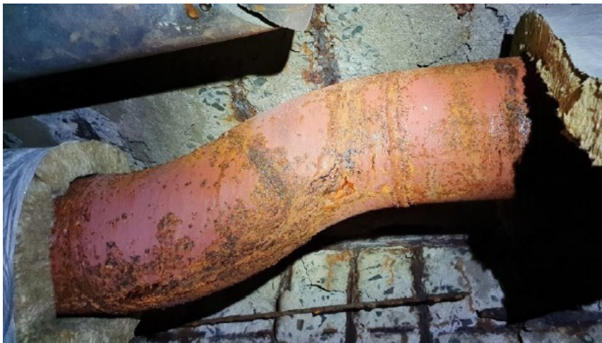
Obrázek 41: Povrchové koroze části neizolované části horkovodního potrubí v potrubním kolektoru
