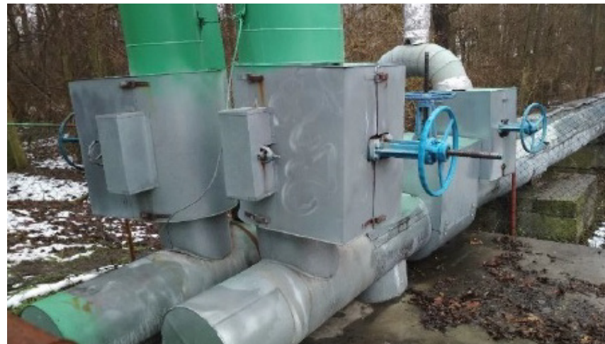
Obrázek 48: Neoznačené potrubí a armatury horkovodu
