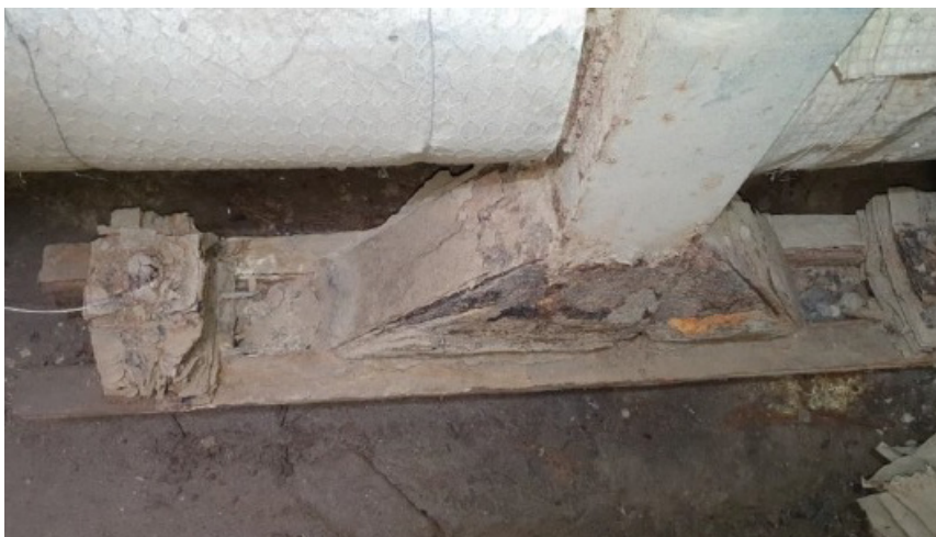
Obrázek 45: Poškození opěrné konstrukce horkovodního potrubí v potrubním kolektoru
